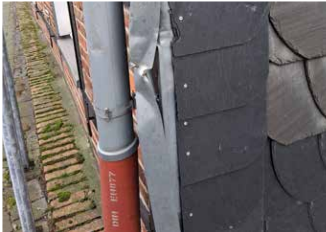
Schäden als Folge beim Abbiegen Foto: C. Grünewald
